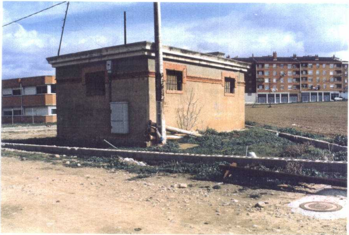
CAPTACION DEL POZO MAZO. ABASTECIMIENTO A HARO.
