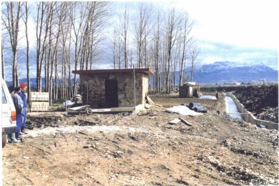
CAPTACION DE LA FUENTE DEL ESTRECHO. ABASTECIMIENTO A HARO.
